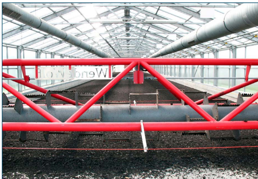
Fot. 3. Hala suszarnicza osadów ściekowych - wewnątrz
